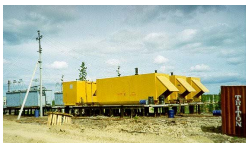
Северная Нефть Дизельные мотор-генераторы, 3х1МВт
