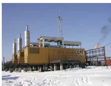
НовосибирскНефтеГаз Газовые мотор-генераторы, попутный газ, 3х1МВт
